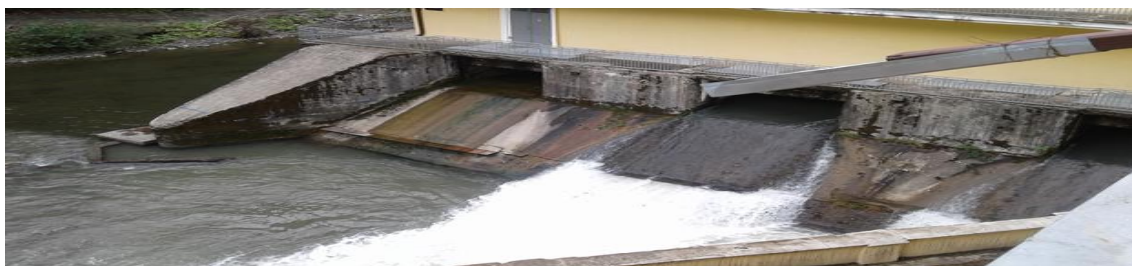
Рисунок 19. Сброс воды с работающих силовых агрегатов Сухум ГЭС
