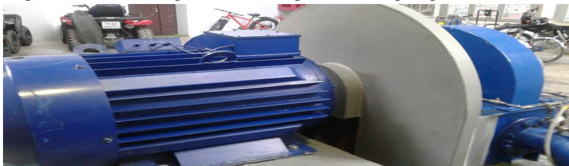
Рисунок 21. Асинхронный двигатель в режиме генератора, с системой стабилизации напряжения и элементом альтернативной дополнительно-свободной энергией (АД-СЭ), мощностью 104 кВт на Сухум ГЭС
