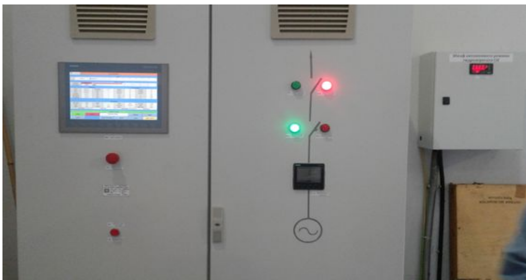
Рисунок 2.12.4. Шкаф системы регулирования выходного напряжения АГ с элементом АД-СЭ
